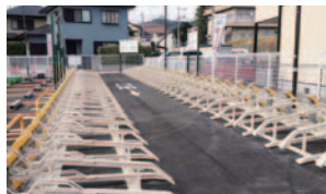
駐輪機器設置
